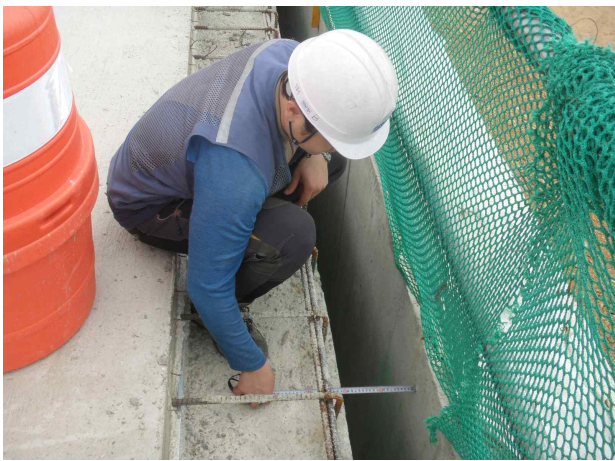
종점측 슬래브 신축유간 측정(21cm)-설계 21cm
